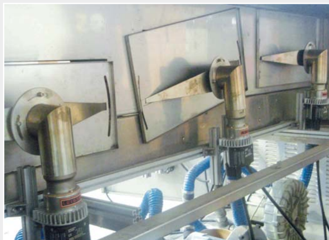
Individuelle Ausrichtung der Leister-Breitschlitzdüsen auf das Schrumpfgut.
