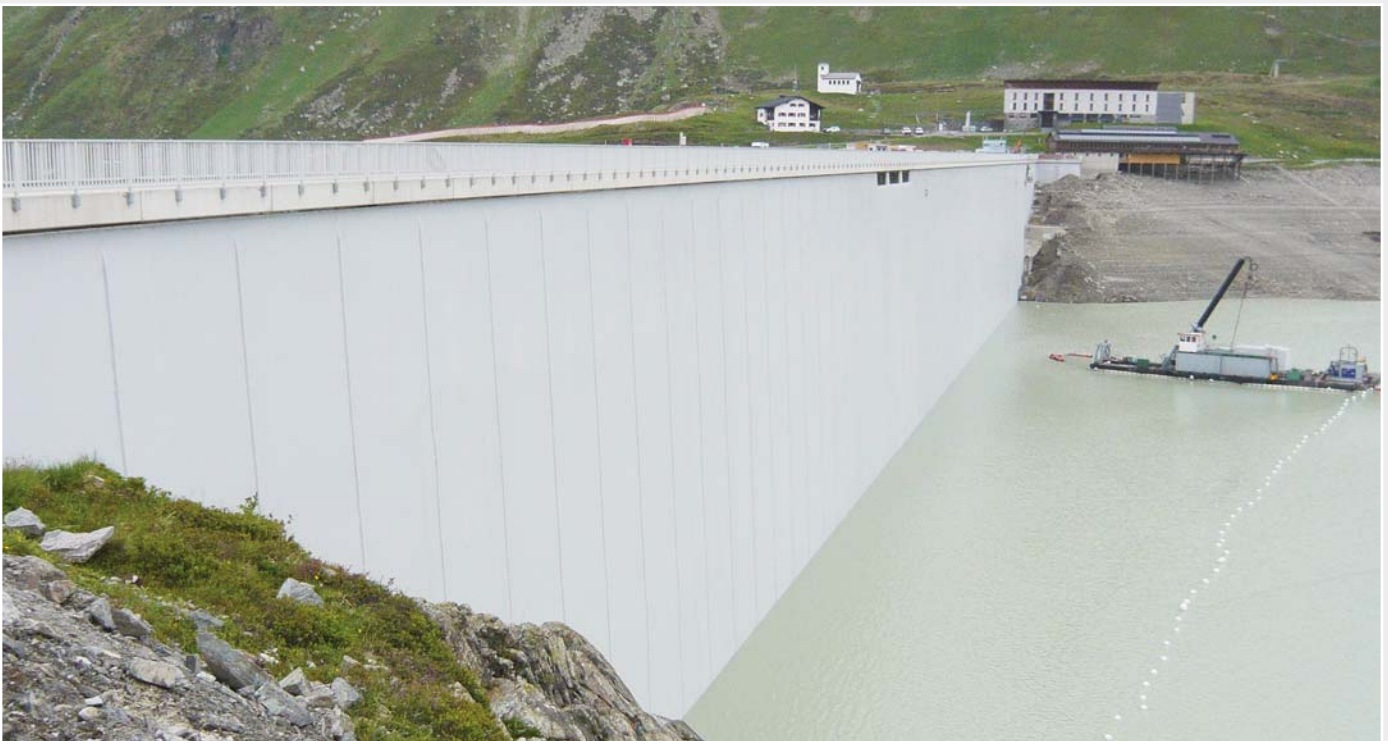
Die abgedichtete Hauptmauer. Die Arbeiten am unteren Drittel werden im nächsten Frühjahr abgeschlossen, wenn der See entleert ist.
