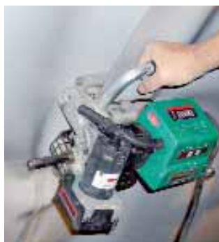
TWINNY T avec poignée transversale pratique pour des soudures en angle au plafond dans un tunnel.
