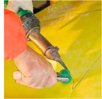
Rullo pressore come accessorio indispensabile nei tunnel.
