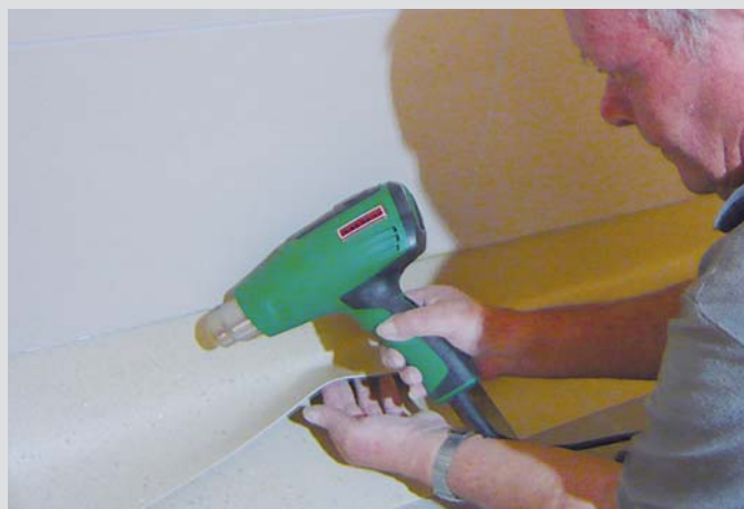
Rápida deformación de revestimientos de suelos
