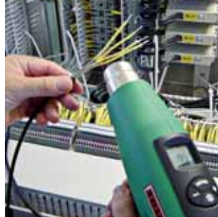
Retracción de etiquetas de cables.
