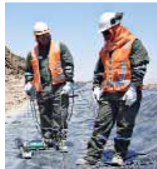
TWINNY S con cuña combinada realizando soldaduras en una mina en Sudamérica.
