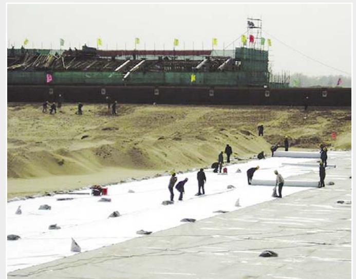
Diariamente se sella con geomembrana de PEAD una superficie total equivalente a dos campos de fútbol.
